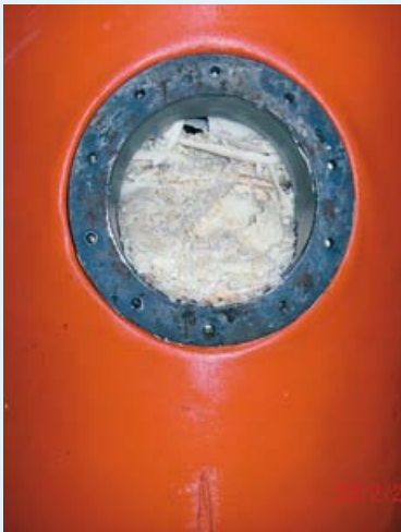
Die Ausgangssituation: verkalkter Warmwasserboiler.
