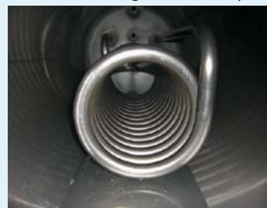
Warmwasserboiler nach der Entkalkung
