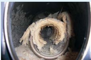
Warmwasserboiler vor der Entkalkung
